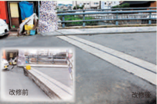
地震により取付部が沈下した鉾田橋
