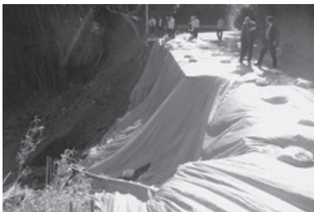
台風 26 号により崩落した中居地内市道
