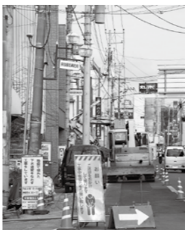
復旧が進む新町
