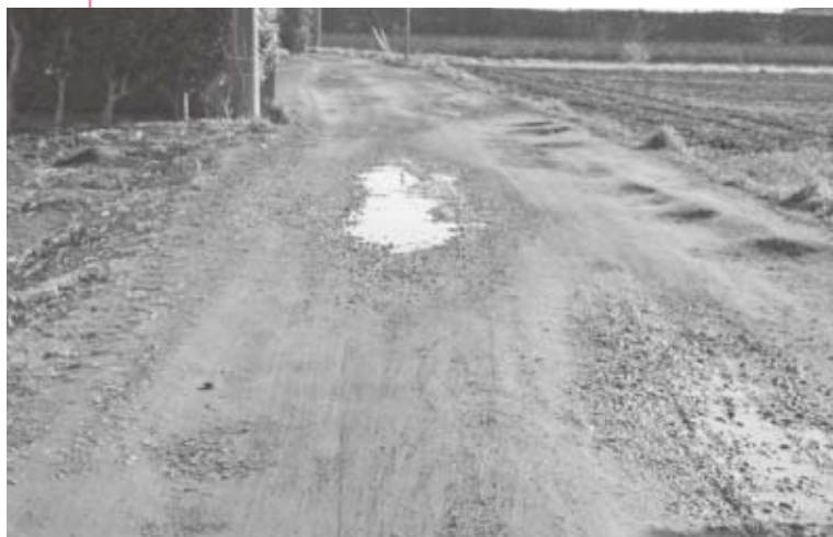
上沢地区の未舗装の道路
