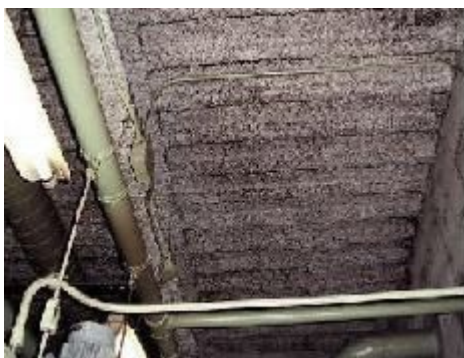
石綿含有吹付けロックウール
